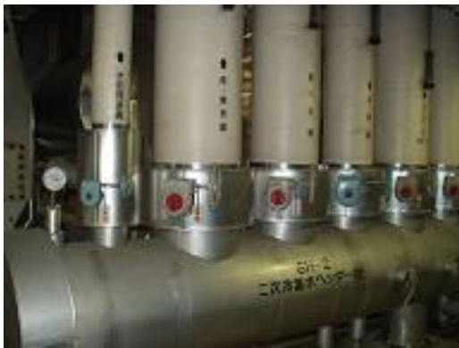
(写真-3) 冷温水ヘッダー
