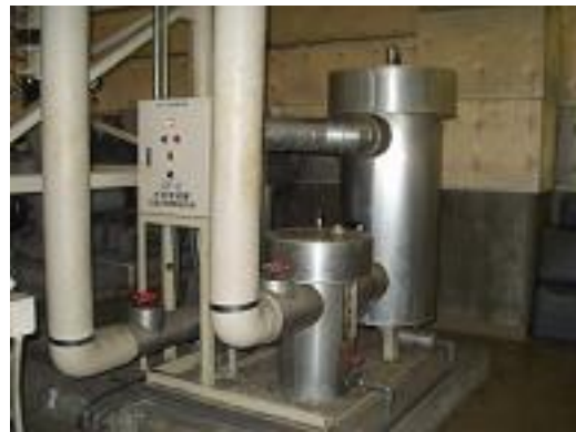
(写真-4) ろ過防錆装置
