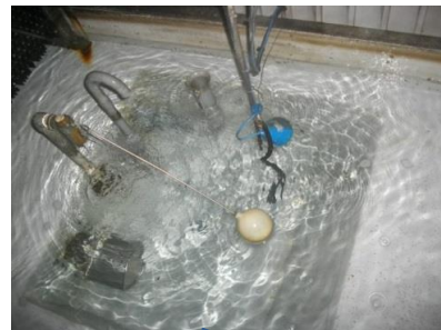
冷却塔のルーバーの水 槽もきれいになりました
