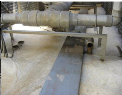
汚れた冷却塔は非効率的です
